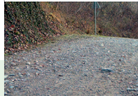
Eingeschränkter Komfort, holpriger Deckbelag | Confort limité, revêtement naturel grossier et inégal | Confort limitato, rivestimento naturale grosso e irregolare
